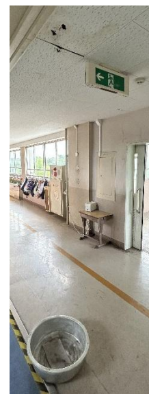
天井からの雨漏りに 対応するためのタライ
