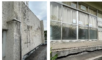
一屋上の外壁剥離と保健室前のひび割れ
