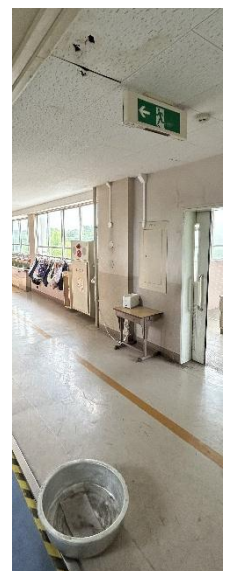
天井からの雨漏りに対応するためのタライ
